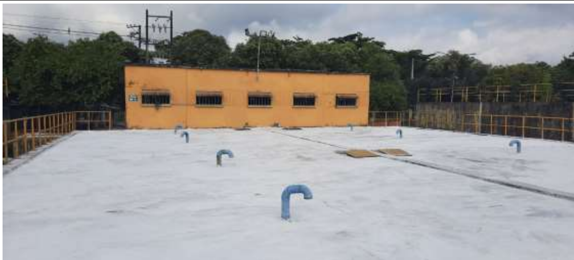
Figura 4 Área de instalación. Cuarto eléctrico y de máquinas. Vista del transformador atrás.
