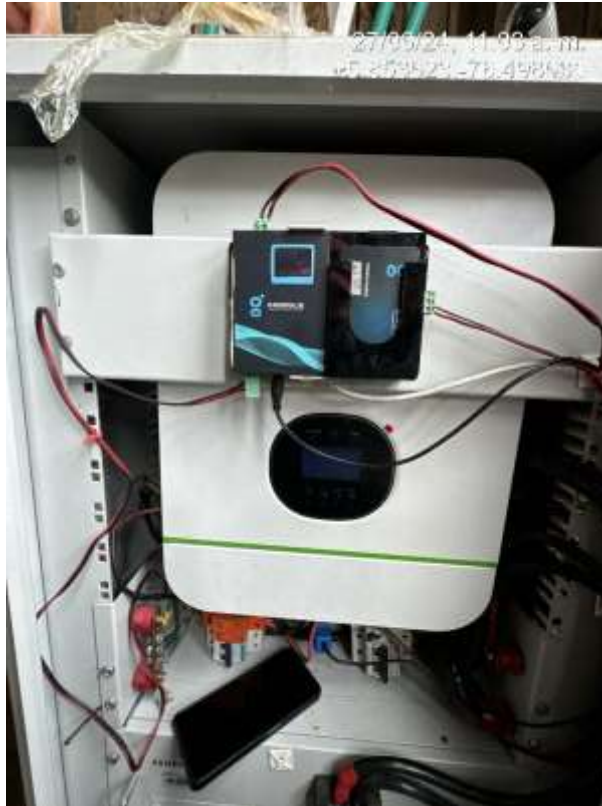
Foto 2. Inversor/Controlador de SSFV fuera de servicio, IE José Melanio Tunay del 31.
