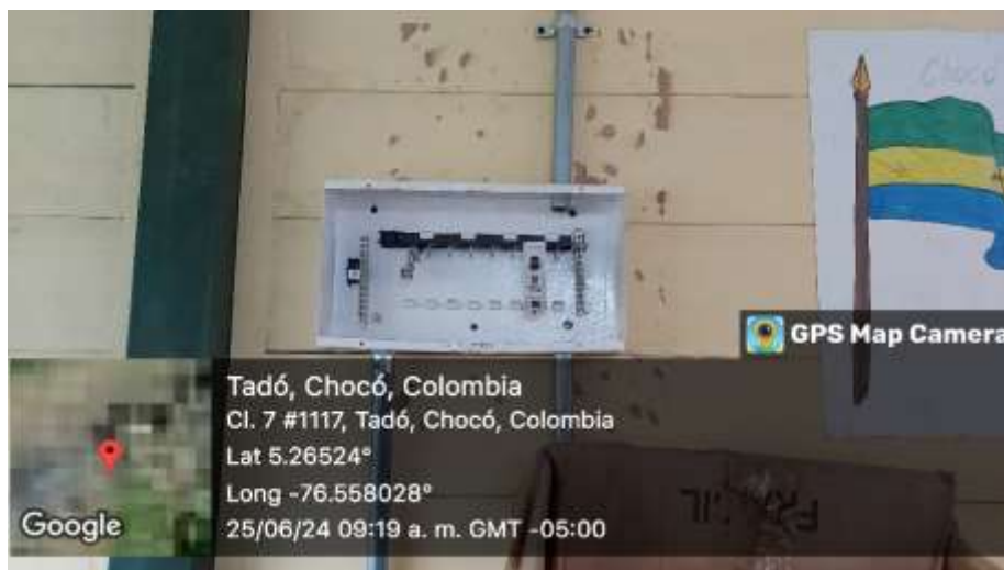
Foto 1. Tablero de distribución eléctrica hurtado de SSFV, IE Técnico Agroindustrial
