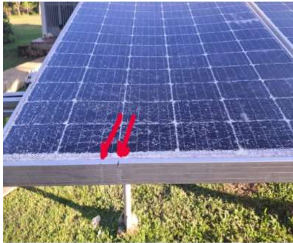
Foto 4. Módulos solares en mal estado SSFV fuera de servicio, ESE San Rafael, El Encanto.
