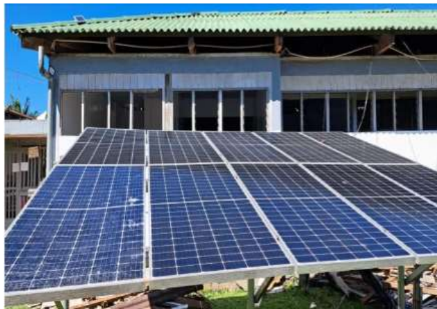
Foto 3. Módulos solares en mal estado SSFV fuera de servicio, ESE San Rafael, El Encanto.
