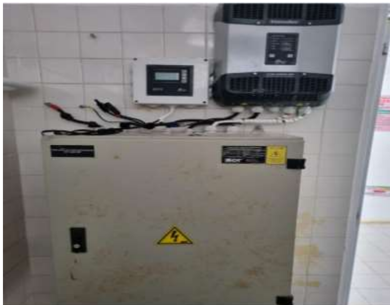
Foto 5. Gabinete, Inversor y Controlador de carga de SSFV fuera de servicio, ESE San Rafael, Puerto Santander.
