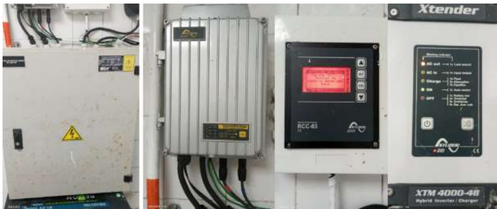
Foto 5. Inversor y Controlador de carga de SSFV fuera de servicio, ESE San Rafael, Puerto Arica.
