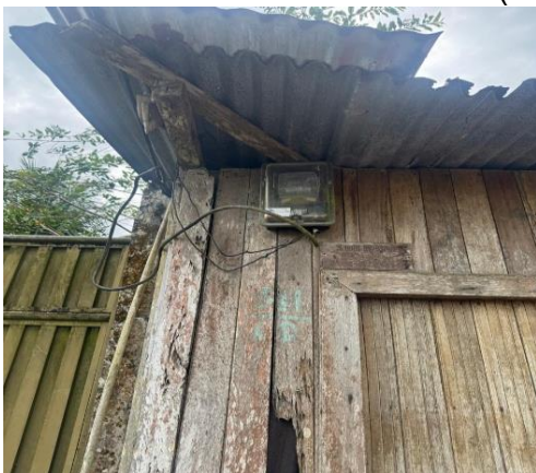
Fig. 3. Usuario con conexión antitécnica a la red de distribución de la JAC Llorente Fuente: Visita de campo de la CGR
